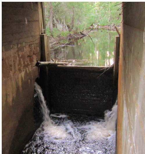
Den läckande dammen före projektet.
