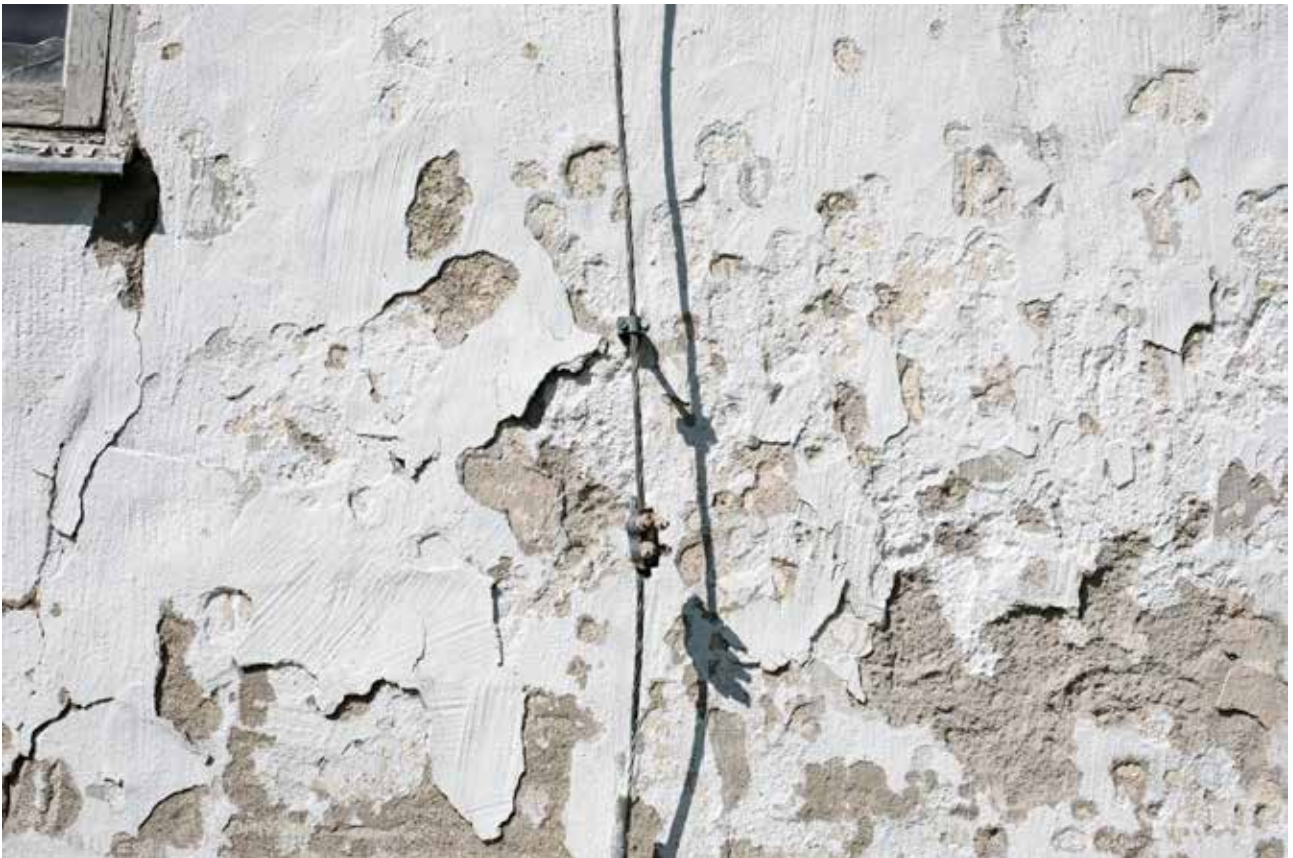
Skadad puts på ladugårdsvägg, maj 2023.
