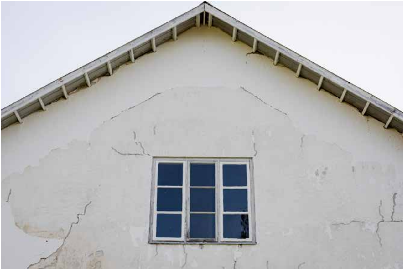
Frånvaro av puts på vägg runt fönster på ladugården, oktober 2023.
