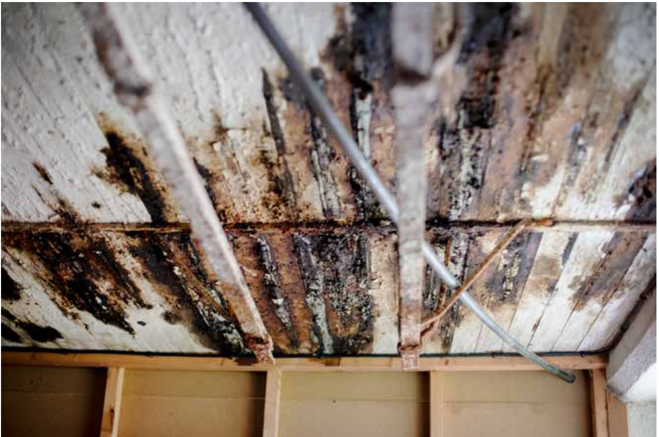
Fuktskada i ladugårdens norra del, oktober 2023.
