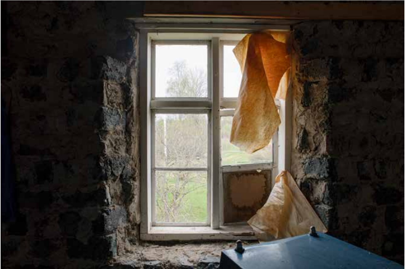
Fönster i behov av renovering i stallbyggnaden, maj 2023.
